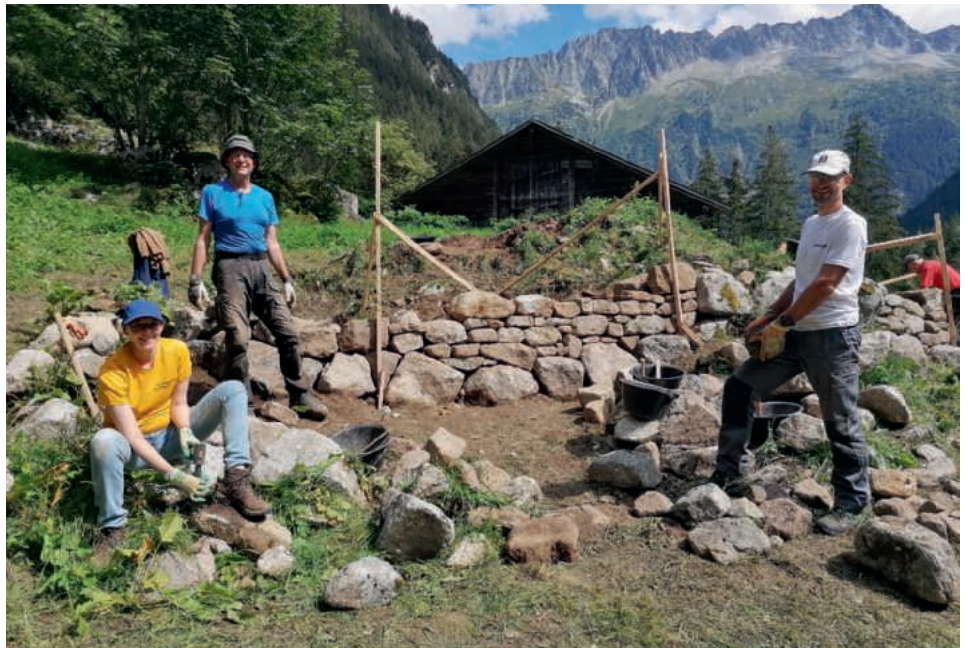
Bild oben: Entsteinen und Pflegearbeiten auf den Alpweiden der Alp Panära (SG). Bild unten: Sanierung einer Trockenmauer im Meiental (UR).
